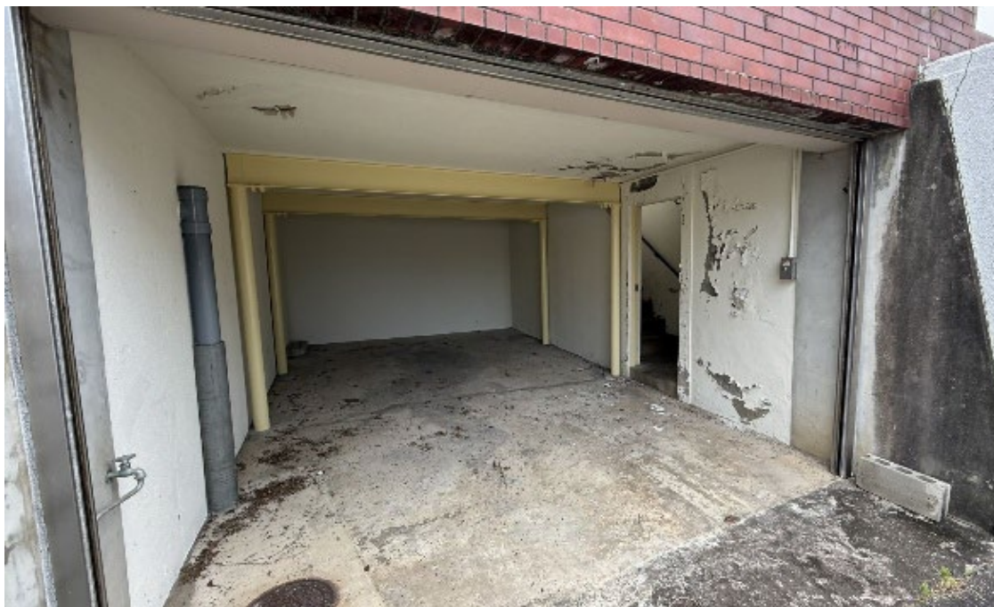
堀車庫（向かって右側 壁・天井の裂傷目立つ）
