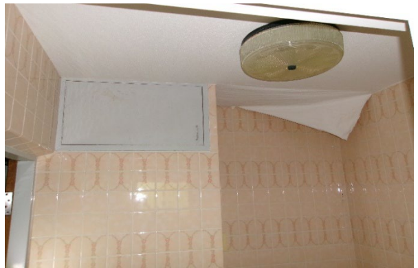
脱衣所（壁紙の剥がれあり）
