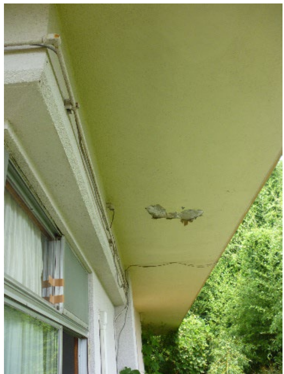
R バルコニー南東側（屋根軒天井 裂傷）
