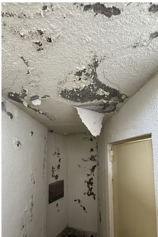
堀車庫から外階段に向かう通路（壁・天井の裂傷が目立ちます）
