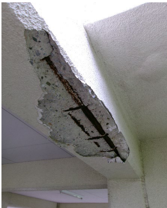
外階段下の1階天井（鉄骨露出）
