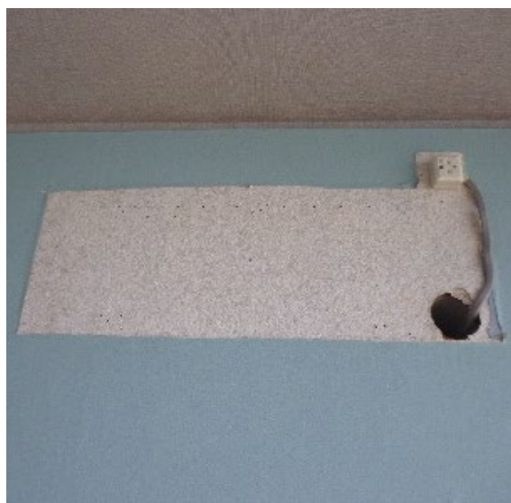
J 洋室① 南東側の壁に剥がれあり
