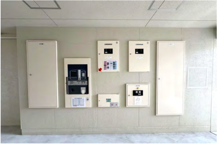
1階通路(電気盤周辺)
