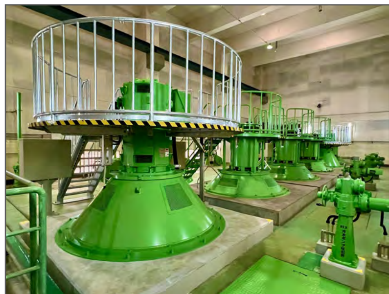
● No.3汚水ポンプ用電動機
