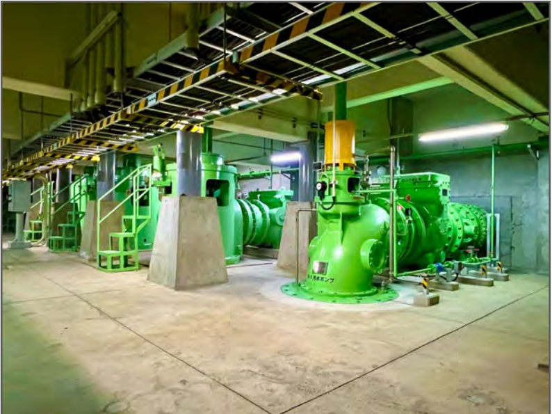
● 沈砂池ポンプ棟 地下1階【汚水ポンプ全景】
