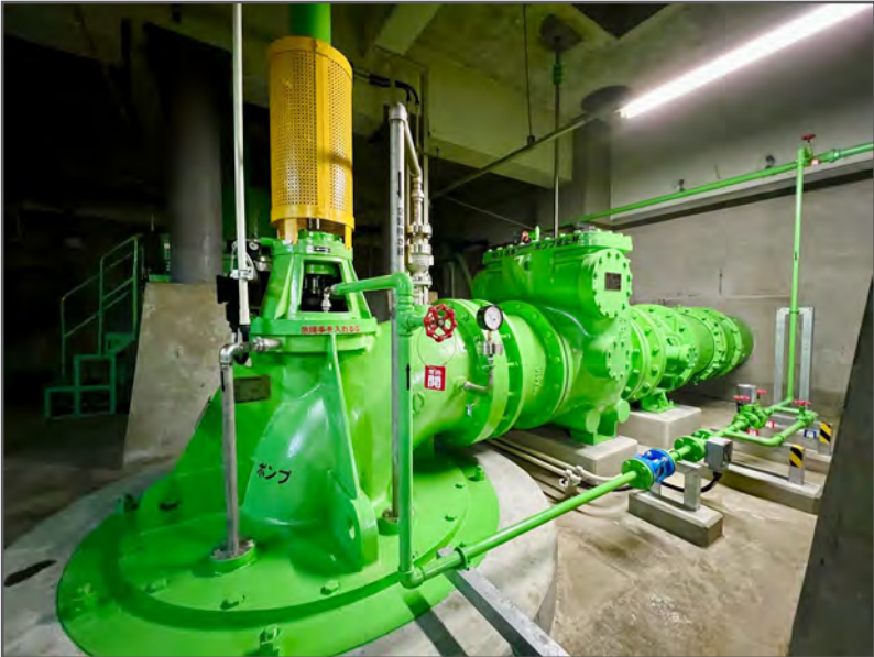
● No.2汚水ポンプ
