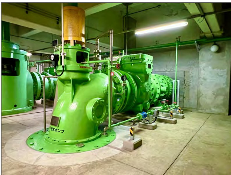
● No.3汚水ポンプ
