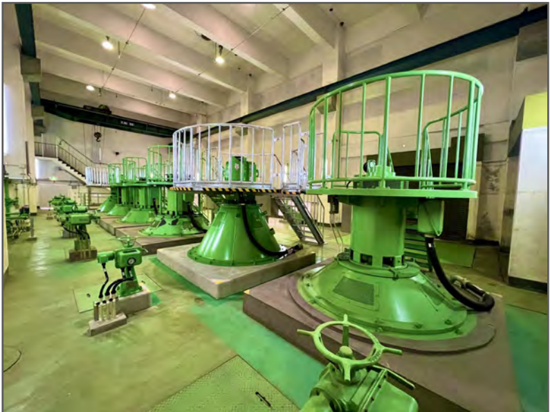
● 沈砂池ポンプ棟 1階【汚水ポンプ用電動機全景】
