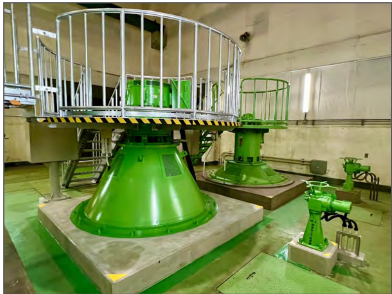
● No.2汚水ポンプ用電動機
