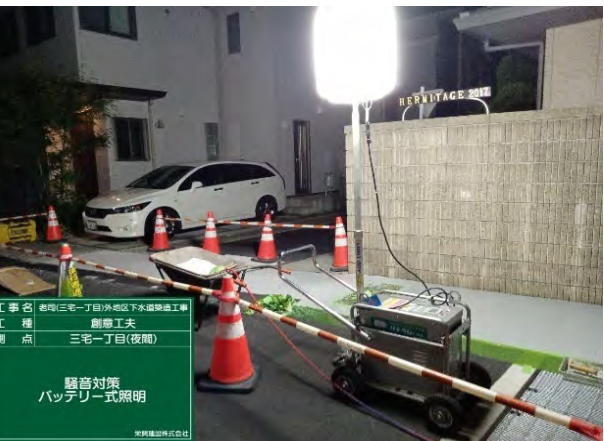
ソーラータイプの照明器材の使用
