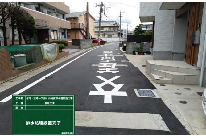
地元の要望に対して排水処理設備を設置
