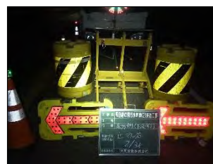
侵入車両強制停止装置の設置
