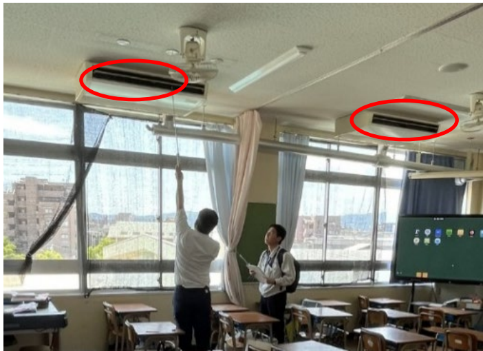
室内機（1部屋に2台）
