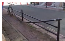
防護柵の破損
