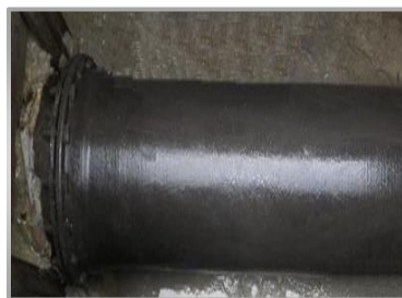
ポリエチレンスリーブ装着管の腐食状況 （ポリエチレンスリーブ取り外し後の写真） 【腐食性土壌 36 年経過】
