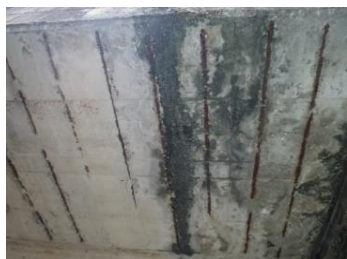
劣化状況（剥離発生）
