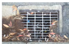
側溝のつまり
