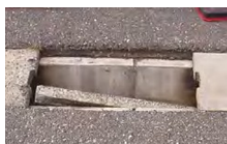
道路や側溝蓋の破損
