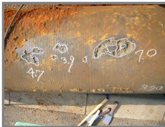
ダクタイル鋳鉄管の腐食状況
