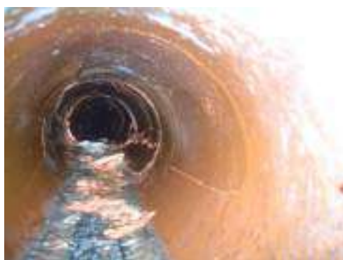
地震により破損した管渠(西戸崎地区)
