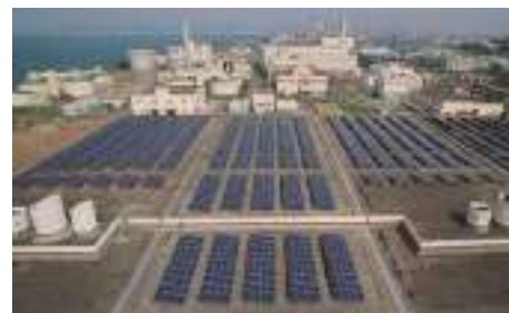
図 4. IV. 3 西部水処理センター 太陽光発電施設
