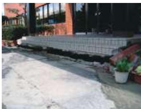
液状化により沈下した西戸崎水処理センター
