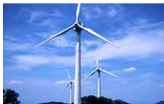
【風力発電設備】
