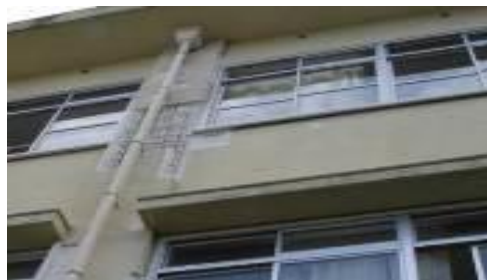
外壁の剥離落下
