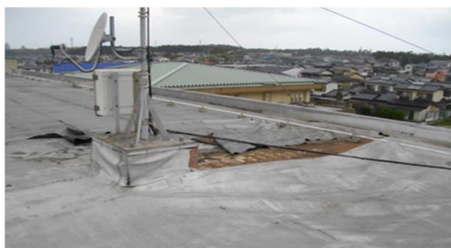
屋上防水シートの破損
