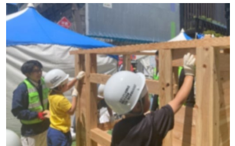
みんなで協力して小さな家を建築 (一社)福岡市建設業協会
