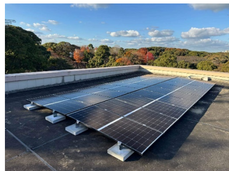
動植物園管理事務所に 設置した太陽光パネル
