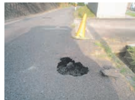
舗装の破損、くぼみ、穴
