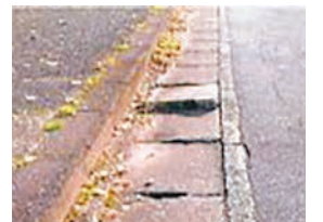
側溝や縁石の破損
