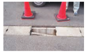
側溝・側溝蓋の破損
