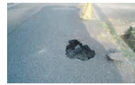
舗装の破損、くぼみ、穴
