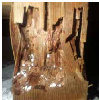
写真 5.2 腐朽による断面欠損
