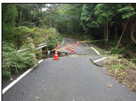
【林道の被災状況】
