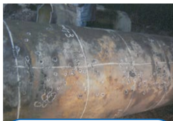
ポリエチレンスリーブ 非装着管の腐食状況(31年経過後)
