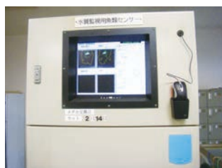
魚類を使った監視装置
