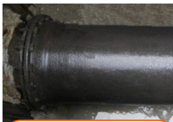
ポリエチレンスリーブ 装着管の腐食状況(36年経過後)
