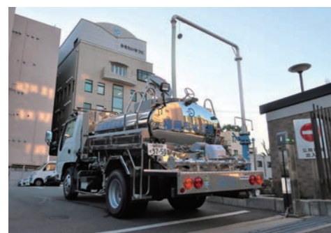
注水設備と給水車
