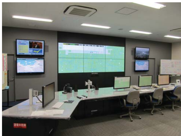
水管理中心中央控制室
