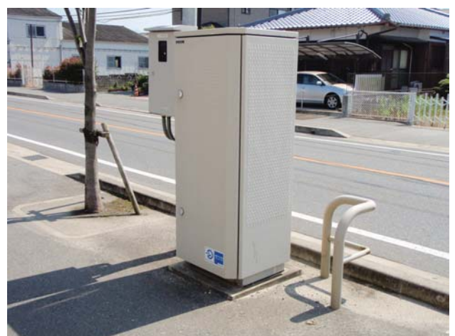
인도상에 설치된 텔레미터
