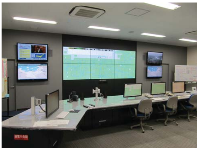
水管理センター 中央コントロール室
