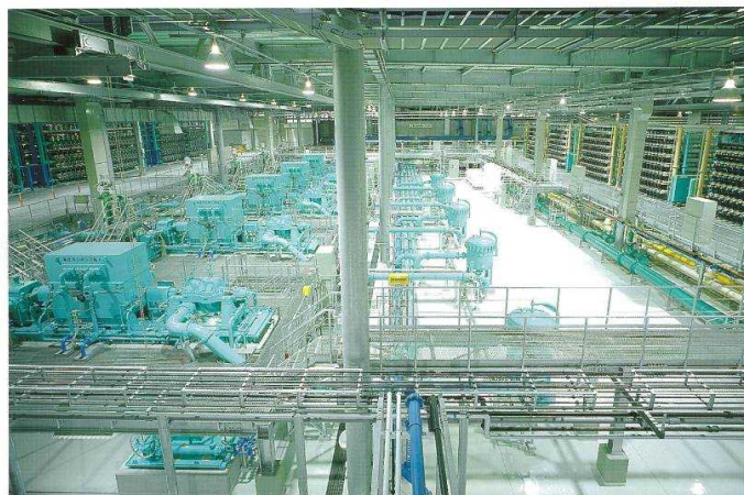
海の中道奈多海水淡水化センター
