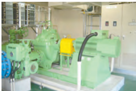
小水力発電設備(乙金浄水場)
