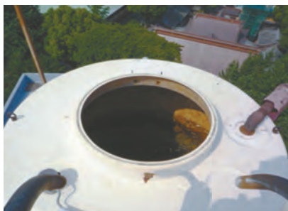
蓋が外れている貯水槽
