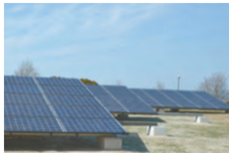
太陽光発電設備(夫婦石浄水場)
