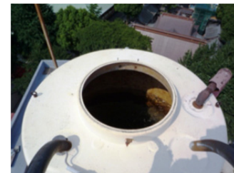
蓋が外れている貯水槽
