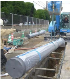
▲ポリエチレンスリーブを装着した配水管
