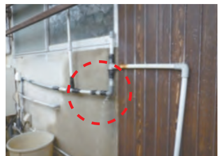
寒波による凍結により破損した給水管
