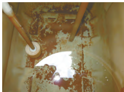
内部に沈積物（鉄さび）が溜まった貯水槽
