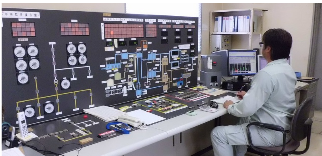
＜ 中央管理室での監視状況 ＞
