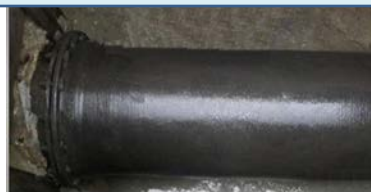
ポリエチレンスリーブ装着管の腐食状況 （ポリエチレンスリーブ取り外し後） 【腐食性土壌36年経過】
