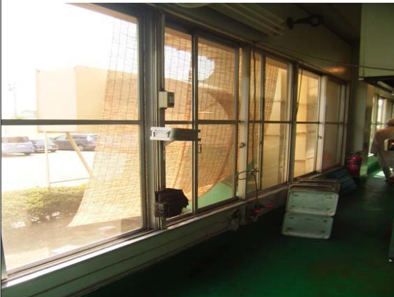
12:窓を開けたまま作業をしている。(温度管理、虫の侵入などの問題が考えられる。)
