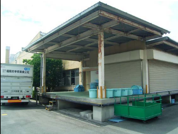
17:一部、地盤が沈下していると思われる場所が見られる。建物が全体的にエキスパンションで接続している部分が多く一体的な構造ではないので、部分ごとにズレを生ずる可能性が高い。
