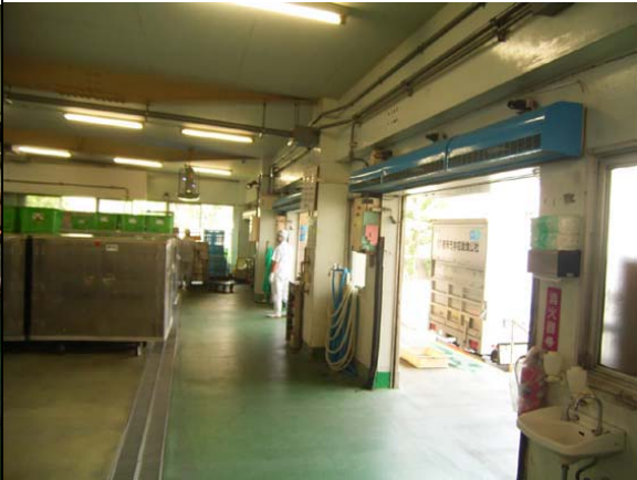
13:コンテナプールとプラットフォームの間に外気を遮断する前室が設けられていない。
