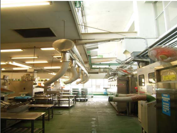
10:梁の露出、配管の露出が多く、埃溜りとなっている。
