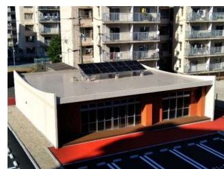
＜弥永住宅集会所に試行設置された太陽光パネル＞
