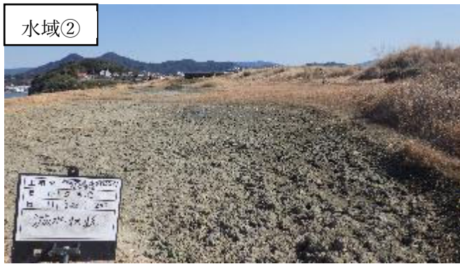
図 2 1 令和 7 年度 1 月減水状況写真
