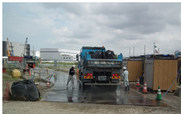
車両洗淨施設
