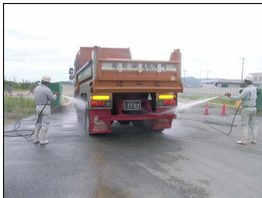
車両洗淨施設
