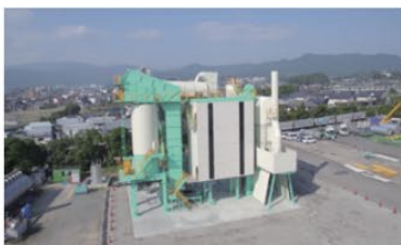
アスファルトを生産する設備「アスファルトプラント」。材料を乾燥加熱するのに燃料を必要とするよ。
