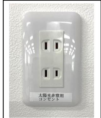
自立運転用 コンセント (非常時のみ)
