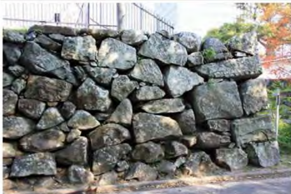
写真2-23:間詰め石の抜け(三ノ丸西)
