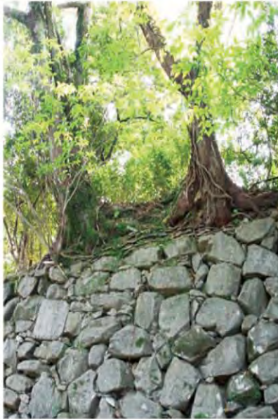
写真2-43:二ノ丸の石垣天端の大木
