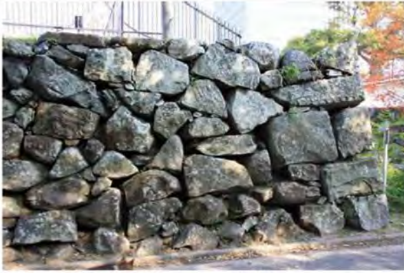
写真2-23: 間詰め石の抜け(三ノ丸西)
