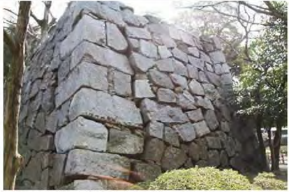
写真2-24: ずれと迫り出し(鉄物櫓跡)
