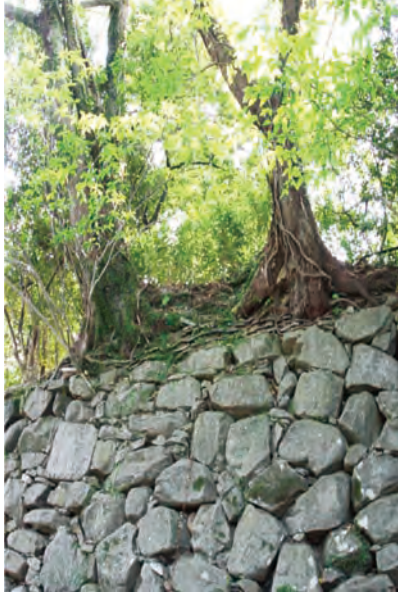
写真-7 ニノ丸の石垣天端の築地と大木
