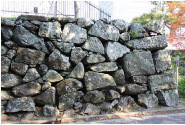
写真-1 間詰め石の抜け(三ノ丸西)
