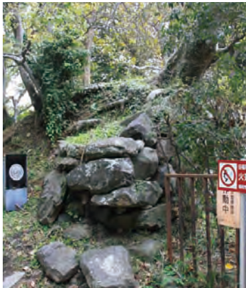
写真-3 壊されたままの石垣 (三ノ丸、名島門南)
