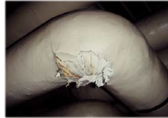
石綿保温材（レベル2）
