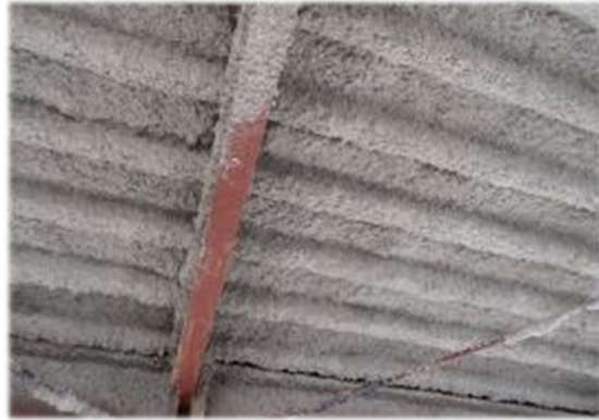
吹付け石綿（レベル1）
