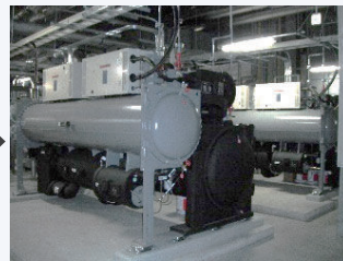
ターボ式冷凍機（電気を使用）
