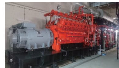
エネルギーセンター (常用自家発電機)
