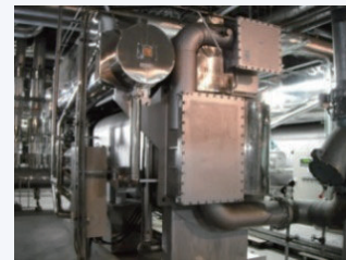
吸収式冷凍機（都市ガス・重油を使用）
