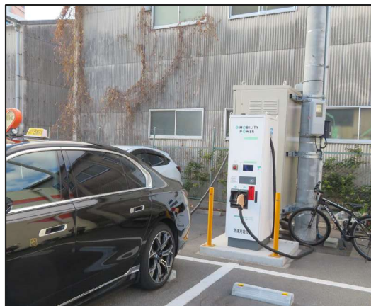
急速充電設備設置事例 (タクシー会社)
