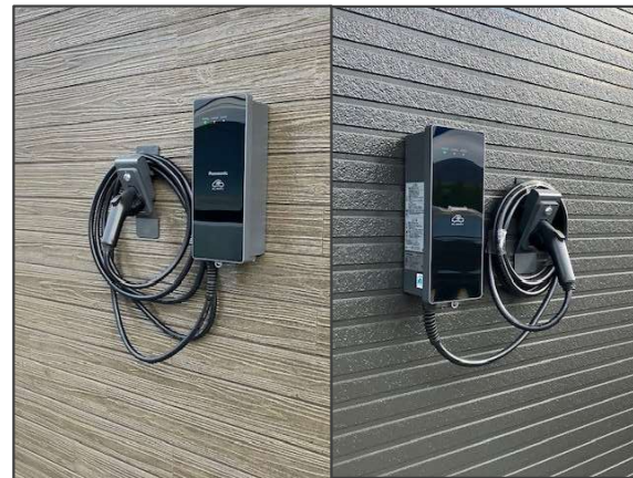
普通充電設備設置事例 (建設会社)
