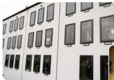
電力メーターを多数設置
