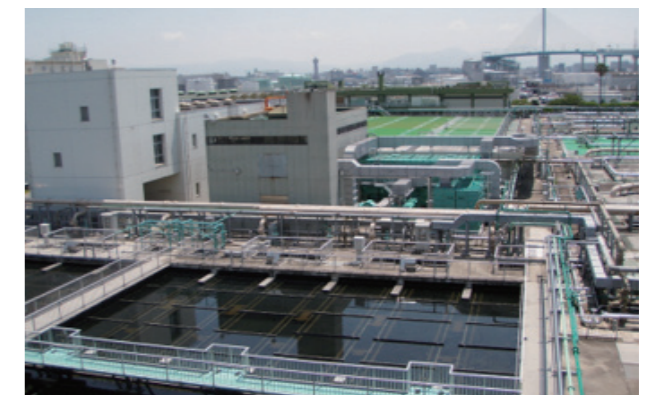
▲水処理センター
