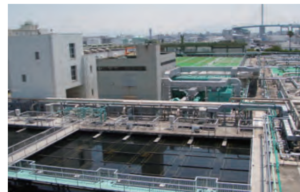
▲水処理センター
