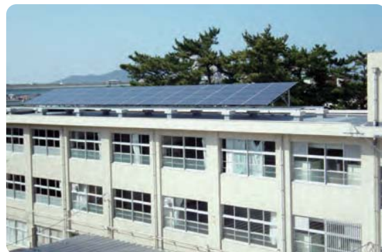
設置している太陽光発電設備
