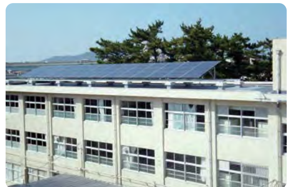
設置している太陽光発電設備
