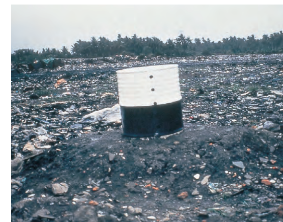
廃ドラム缶を使ったガス抜き設備
