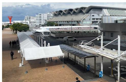
仮設通路（テント）の設置状況 福岡国際会議場からマリンメッセ福岡A・B館方面を臨む
