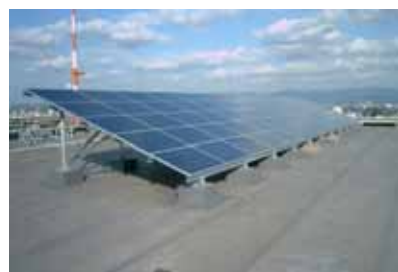
▲ 太陽光発電システム
