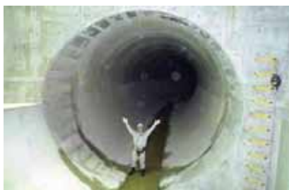
▲ 雨水管渠（比恵 9 号幹線）
