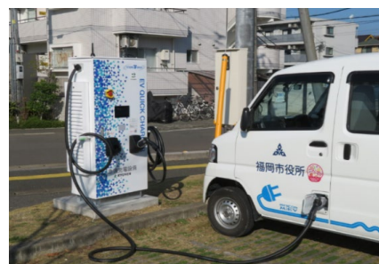
充電設備の設置（西南杜の湖畔公園）
